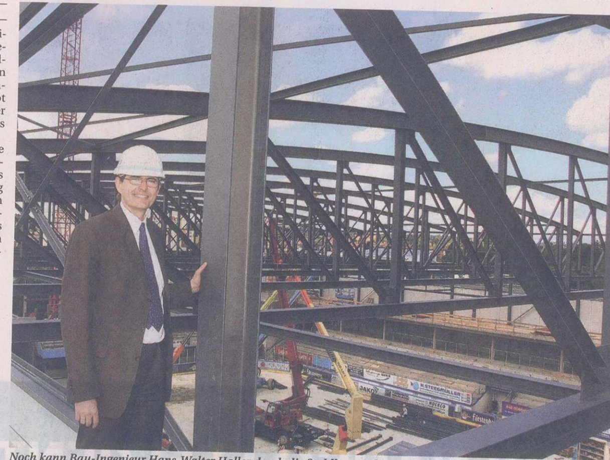
Noch kann Bau-Ingenieur Hans-Walter Haller durch die Stahlkonstruktion den blauen Himmel sehen. Bald aber werden die Träger unter dem neuen Dach der Eishalle verschwinden. Bild: Schönsmuth
