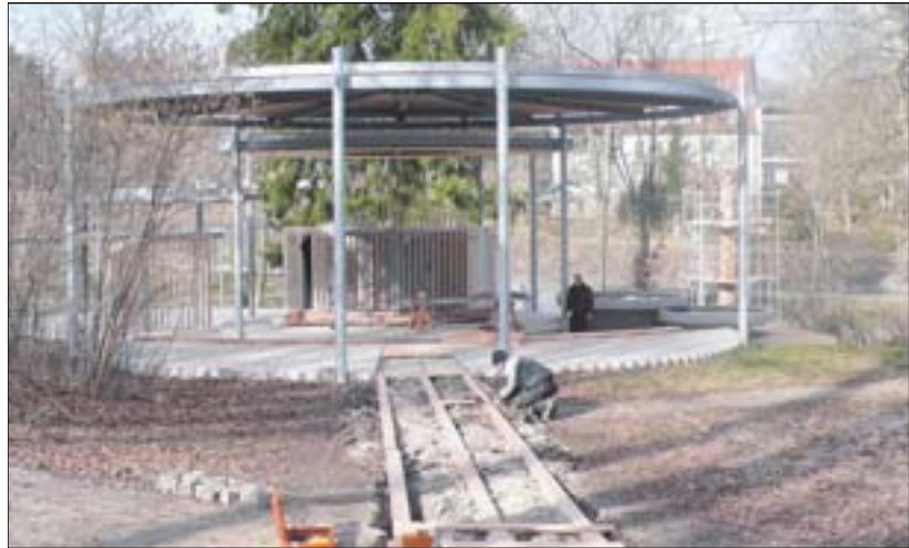
Im Rohbau fertig ist der Kirchenpavillon auf dem Gelände der Landesgartenschau. Fünf christliche Kirchen nutzen ihn zur Präsentation. Foto: LGS
